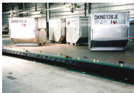
ボールプラットホーム
